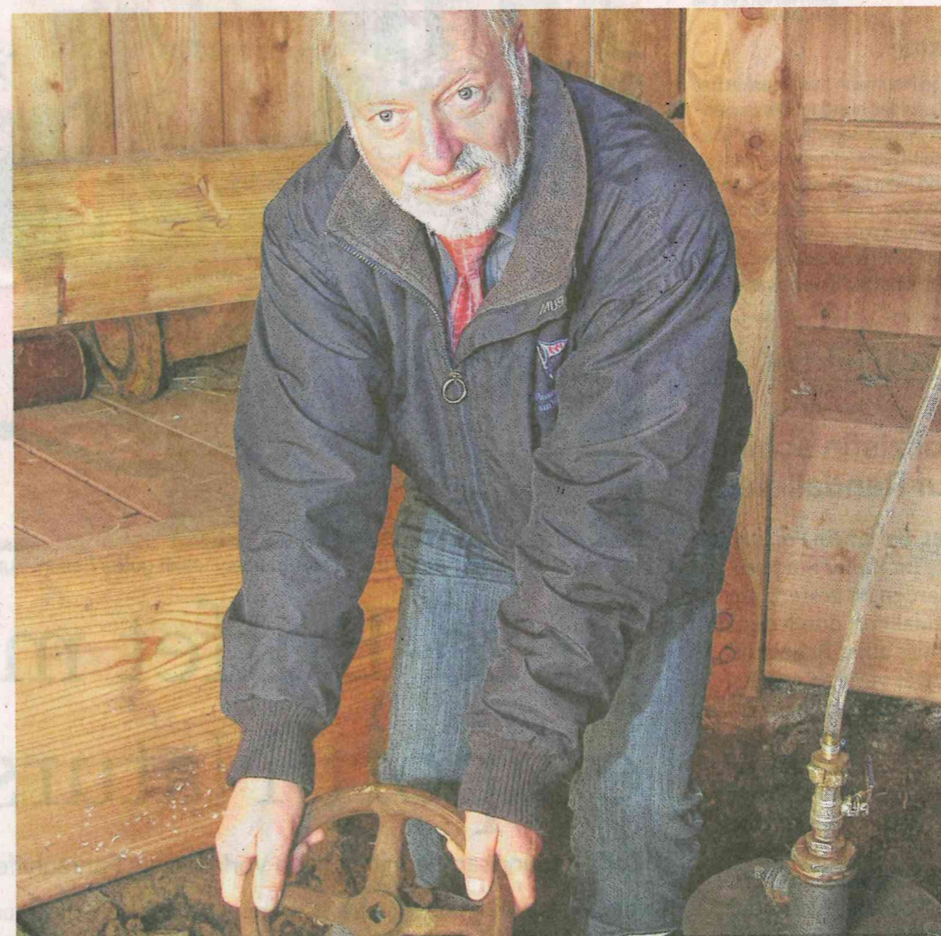
Der Wasserverteiler der Kimberquelle. Bernd Ramm ist Geschäftsführer der Hohenwestedter Werkstatt und Initiator des Projekts. HENZE
